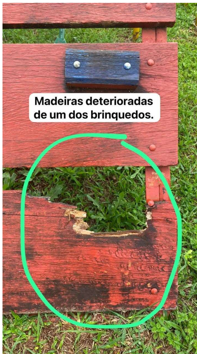
Foto 18 - Madeira deteriorada em brinquedo
